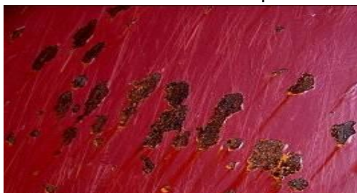
Figura 1 - Corrosão devida a ruptura da camada de tinta
